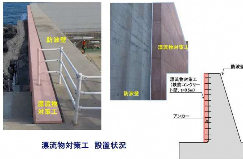
図3 漂流物対策工の設置状況
