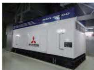
ガスタービン発電機
