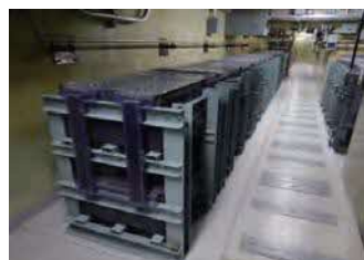
蓄電池（バッテリー）
