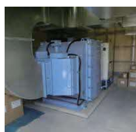
非常時外気取入ユニット (光洋の里)
