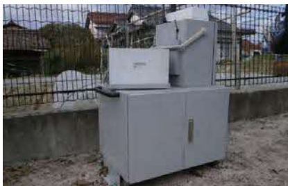
可搬型モニタリングポスト（交番設置）
