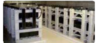
直流電源の強化として、既設の蓄電池の取り替えおよび追加設置
