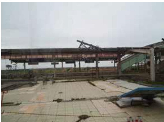
富岡駅周辺の津波被害状況
