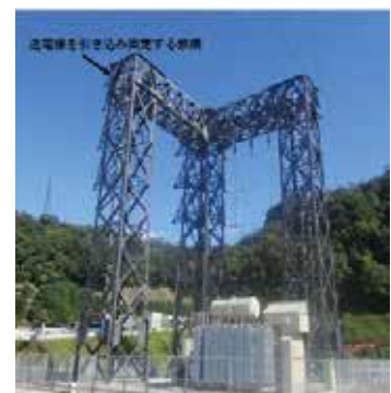
岩盤上に直接鉄構を設置し高い耐震性を有する緊急用開閉所
