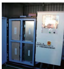
非常時外気取入ユニット (済生会境港総合病院)
