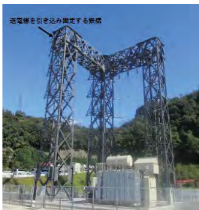
岩盤上に直接鉄構を設置し高い耐震性を有する緊急用開閉所
