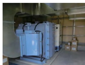
非常時外気取入ユニット (光洋の里)
