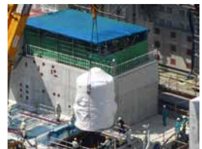
フィルタ付ベントの設置
