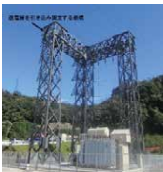
岩盤上に直接鉄構を設置し高い耐震性を有する「第 2 66kV 開閉所」
