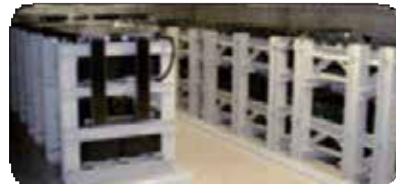
蓄電池（バッテリー）の強化
