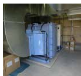
非常時外気取入ユニット (光洋の里)
