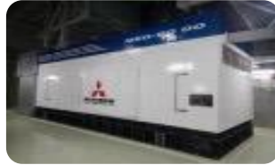
ガスタービン発電機の配備
