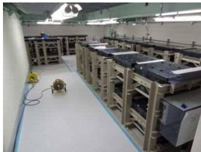
蓄電池(追加設置)
