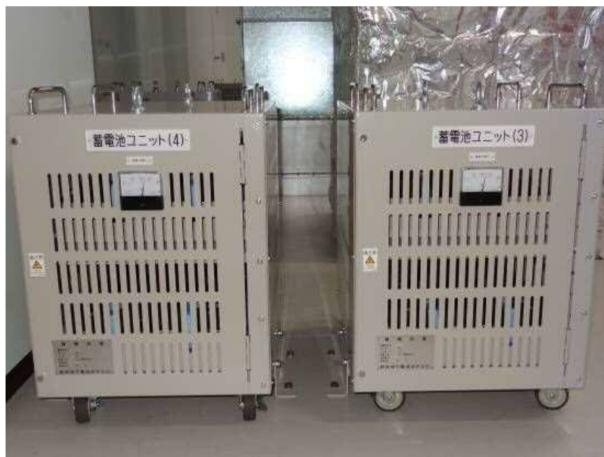
主蒸気逃がし安全弁用蓄電池
