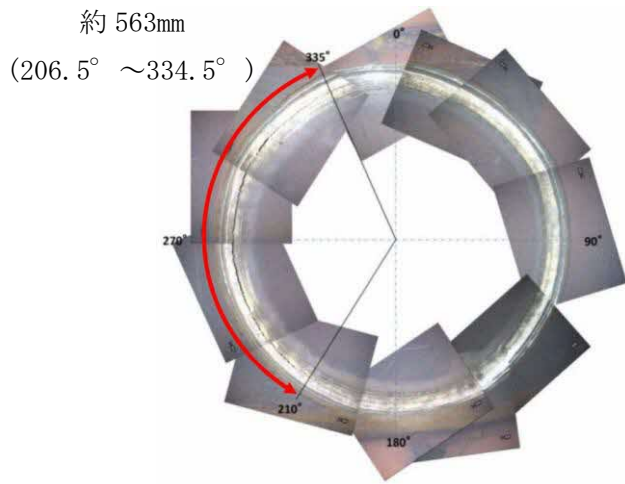
図 4-2 AHC 取付溶接部に発生したひび
