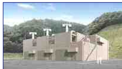
▲ガスタービン発電機
