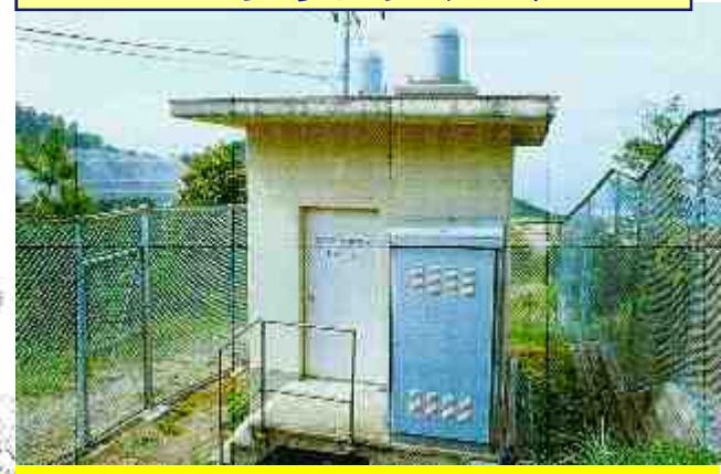
○ 敷地周辺の放射線量などを監視する
