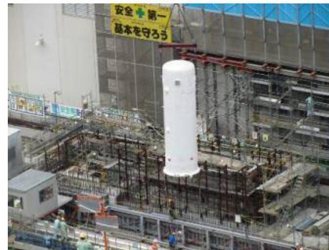
▲フィルタ設備(2号機)
