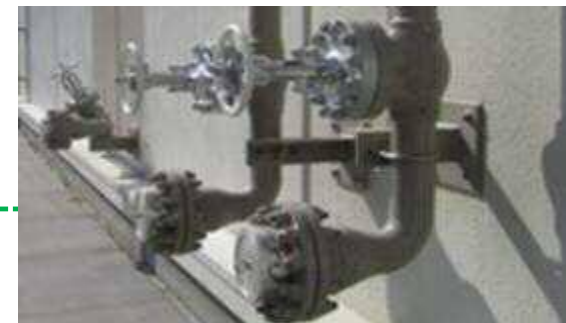
▲送水車接続口等を設置し、対応を迅速化
