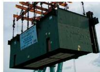
制御棒駆動機構室 ルームモジュール
