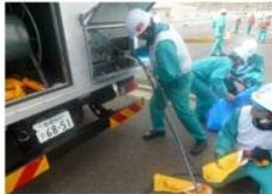
▲発電機車接続訓練
