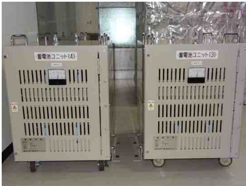
主蒸気逃がし安全弁用蓄電池
