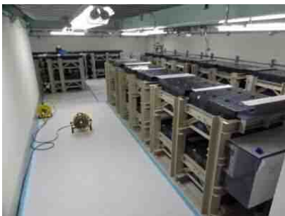
蓄電池(追加設置)
