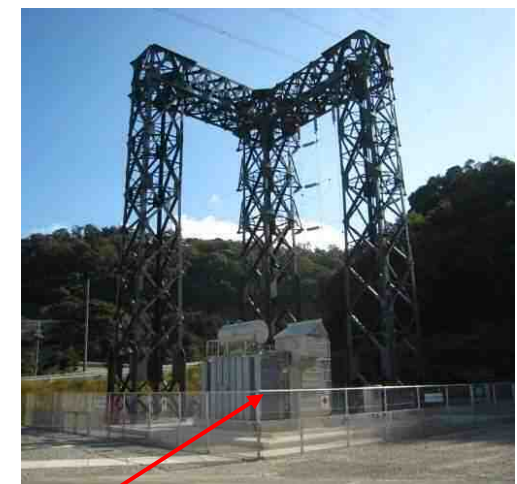
66kV受電設備 第2予備変圧器
