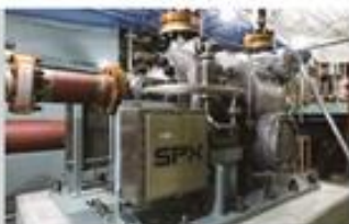
高圧原子炉代替注水ポンプ
