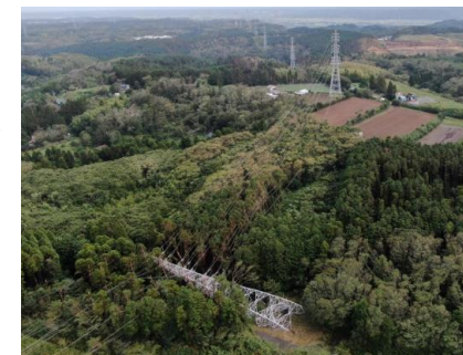
鉄塔設備の倒壊（君津市）
