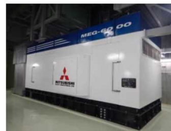
ガスタービン発電機
