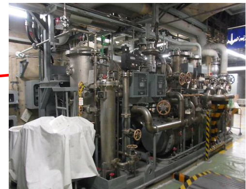
固定子冷却設備※
