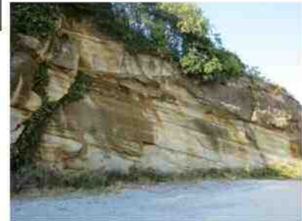
P5 開削面露頭 地滑り土塊とされる箇所を開削した露頭。堅硬な岩盤からなり、地滑り土塊のすべり面は認められない。
