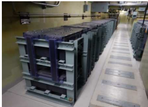
図5-18 蓄電池（バッテリー）
