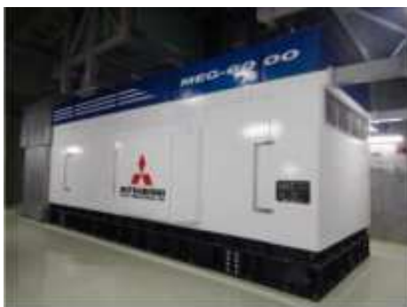
図5-17 ガスタービン発電機
