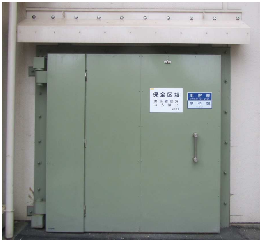
2号機建物外壁に設置した水密扉
