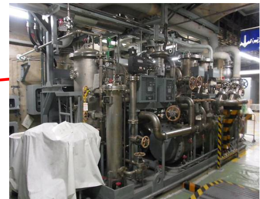
固定子冷却設備※
