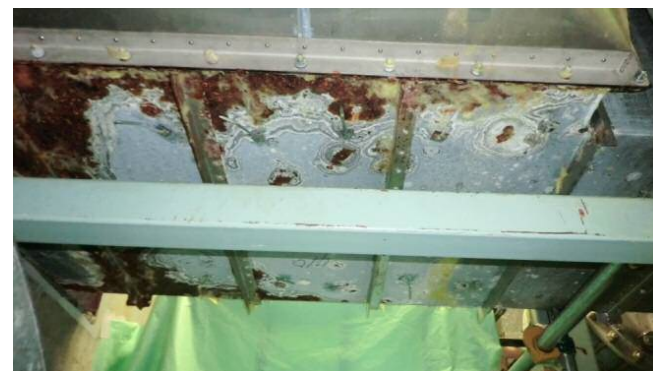
3箇所の腐食の一例
