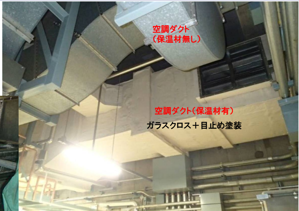
空調ダクトの一例
