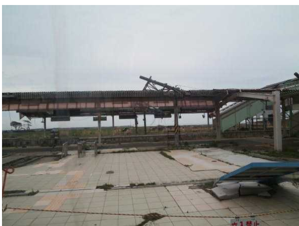
富岡駅周辺の津波被害状況
