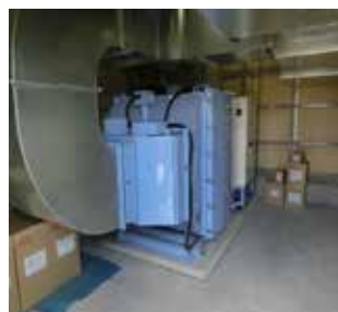
非常時外気取入ユニット （光洋の里）
