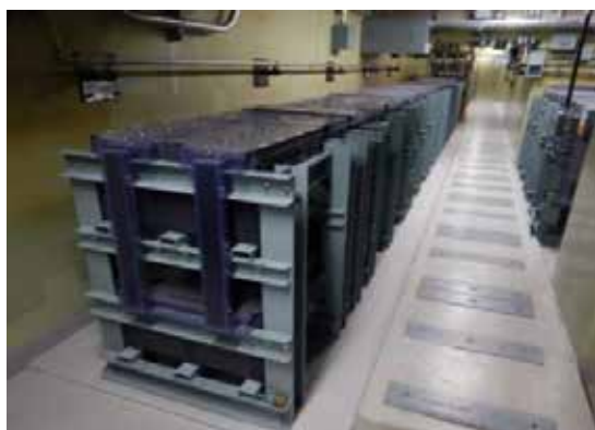
蓄電池（バッテリー）
