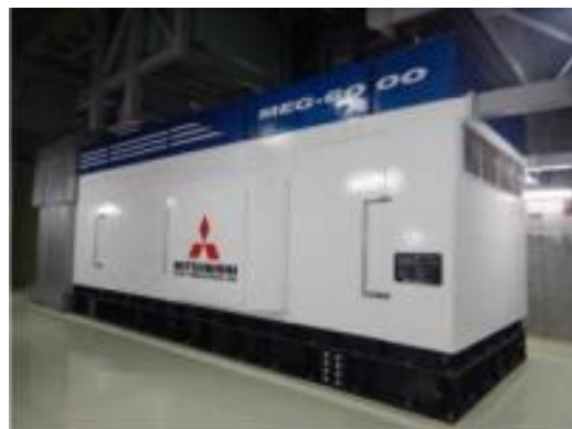
ガスタービン発電機
