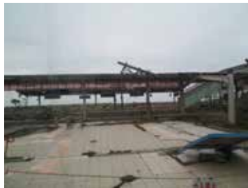
富岡駅周辺津波被害状況
